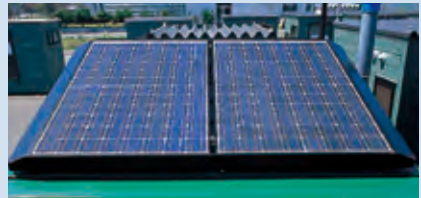
■ソーラー発電用パネル
