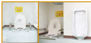
■SKM-75-2DW型内部 (小便器1、大便器2)
