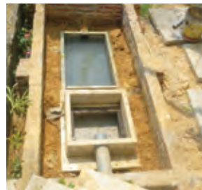
土中に埋設された新浄化装置
